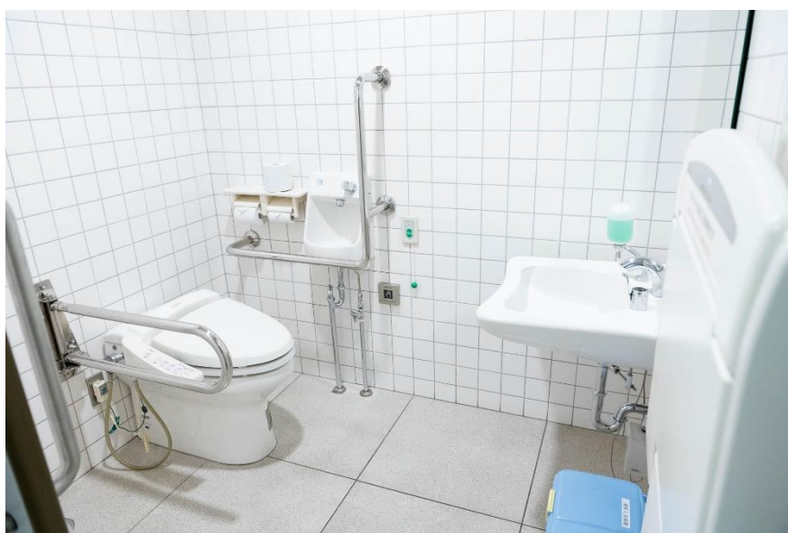
地下1階の 多機能トイレ
