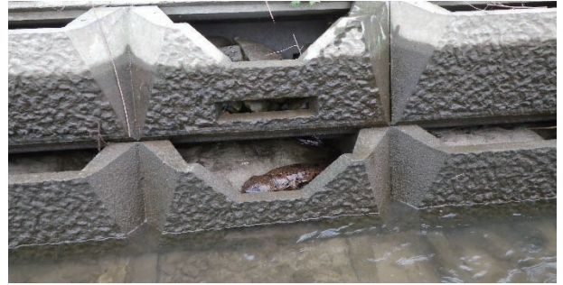
環境型ブロック(伊賀市)
