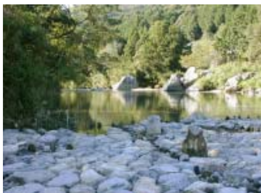
図14 天然石を敷き詰めた床止め工。橋脚周辺の床止めとして天然石を用いた例である。現在、工事中のため露出しているが、再び水没すれば水生昆虫や稚魚のすみかとなると思われる(宮川水系 2003, 奥が上流)。
