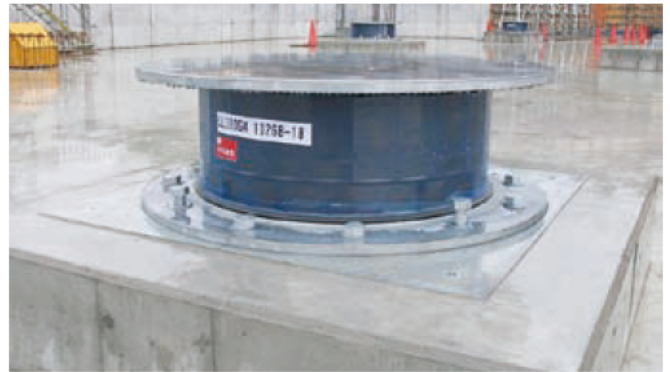
免震装置（鉛プラグ入り積層ゴム支承）
