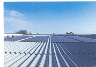
折版屋根と太陽光パネル
