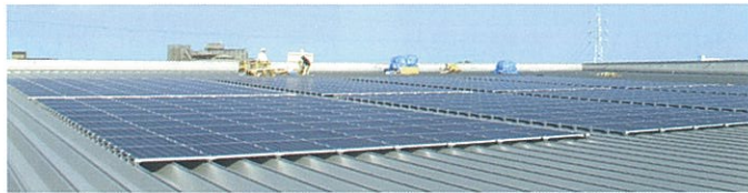
太陽光発電パネル 100kw(平成 24 年 10 月 30 日現在)
